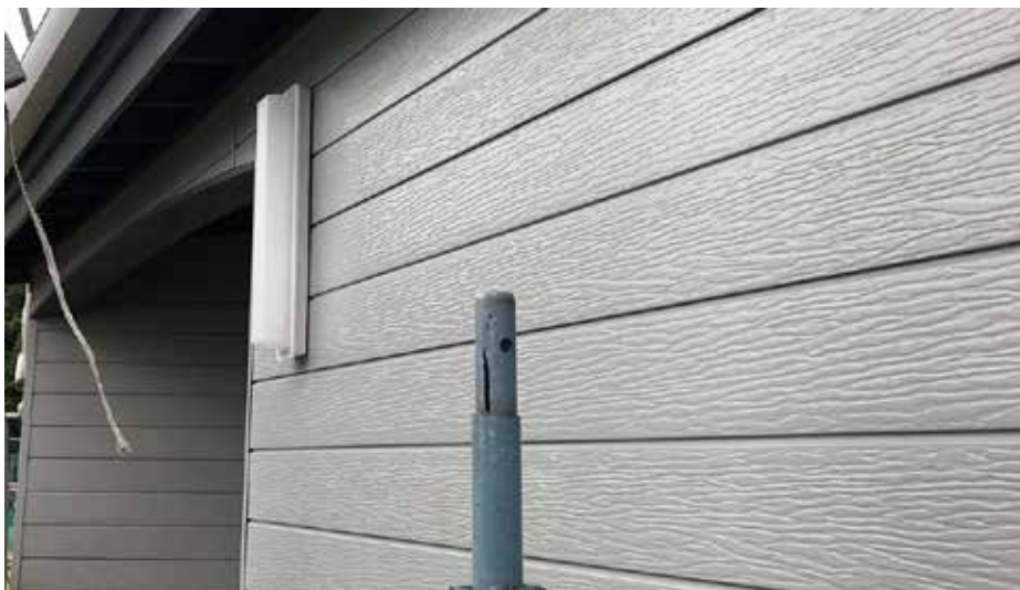
エントランス脇の屋外照明です。
