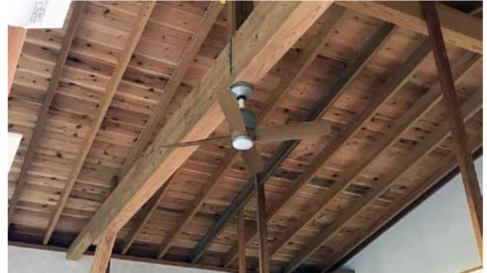
各教室とホールにシーリングファン（天井扇）が付いています。
